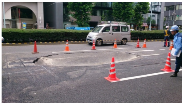
写真R-T.7-1 道路陥没の事例
